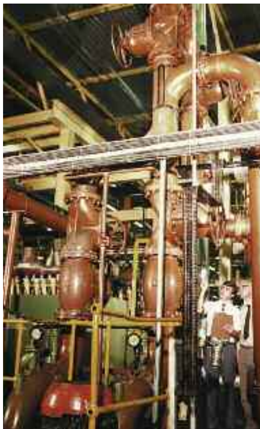
Duże zawory Typu A, zainstalowane w destylarni
